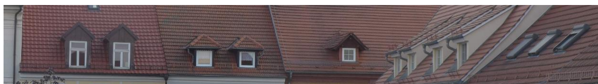
Abb.2a, 2b: SchlepPGAube, Spitzgaube, Walmgauge, Fledermausgaube, Zwerchhaus (oben v. l. n. r.). Die Gebäude am Markt zeigen eine Vielfalt von Dachaufbauten (unten).
